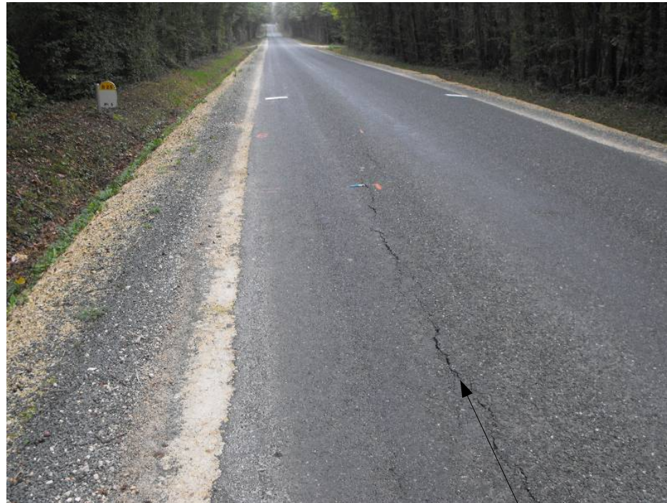
fissure longitudinale importante à un endroit
